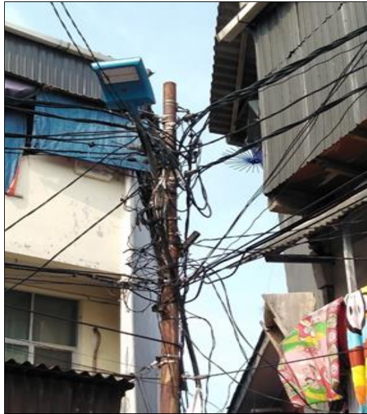
Gambar 10. Kondisi Jaringan listrik
